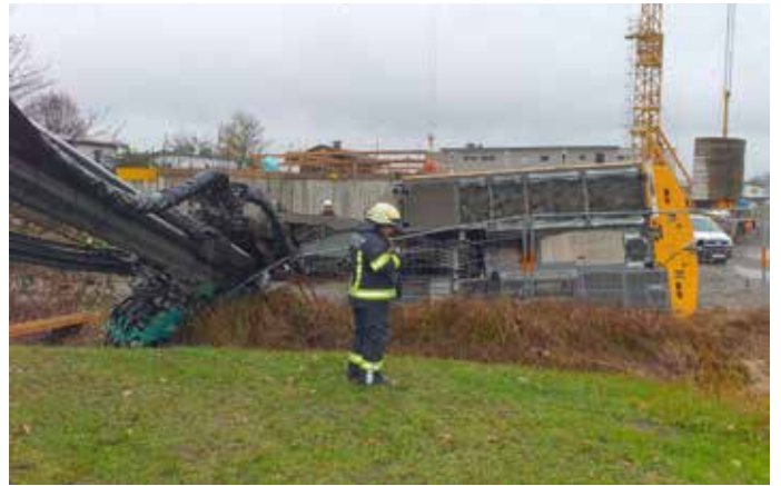
17. November · Dornbirn Bagger umgekippt
