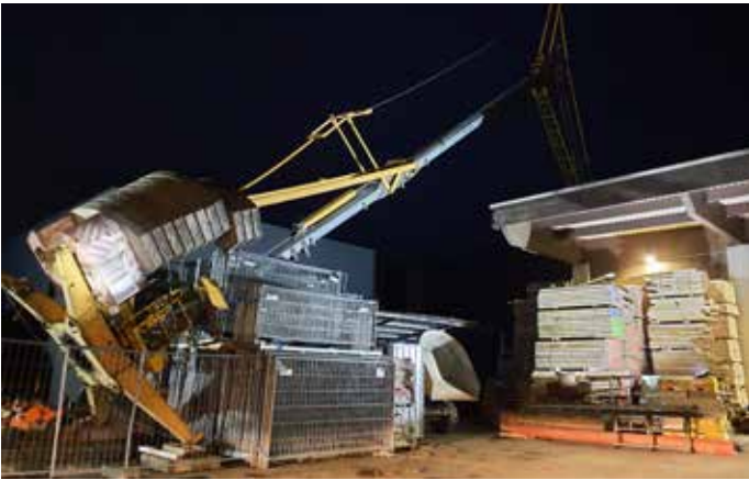
7. November · Hohenems Kran umgestürzt
